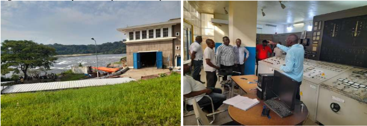
Figure 56 : Station hydroélectrique de la Tshopo :
