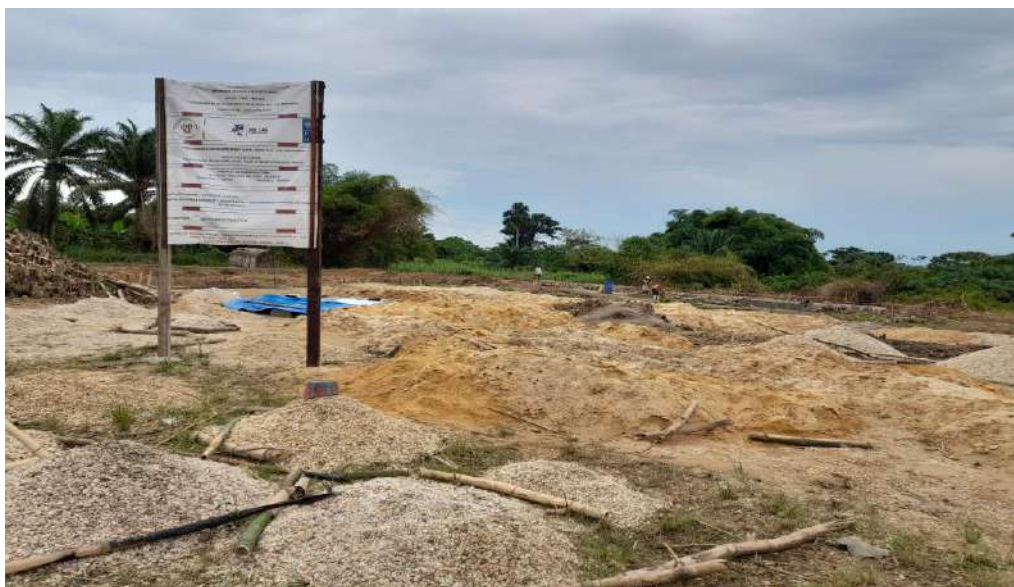
Figure 63 : Illustration de l'exécution des travaux du projet PDL par le PNUD à Lotokila
