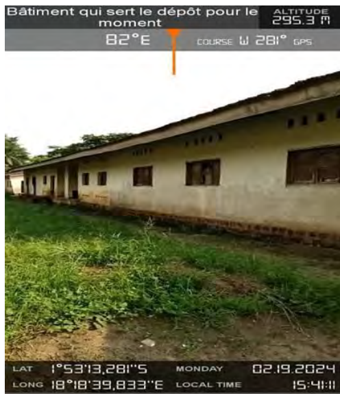
Photo 4 : Etat délabré de l’entrepôt actuellement utilisé à INERA Ikalata, Mai-ndombe
